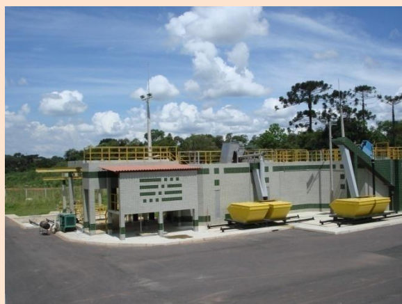
FIGURA 29 – VISTA DO TRATAMENTO PRELIMINAR DA ETE Fonte: SANEPAR, 2008
