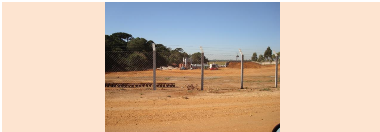
FIGURA 34 – VISTA DA USINA DE ASFALTO EM FASE DE IMPLANTAÇÃO NO ENTORNO DIRETO DO EMPREENDIMENTO
